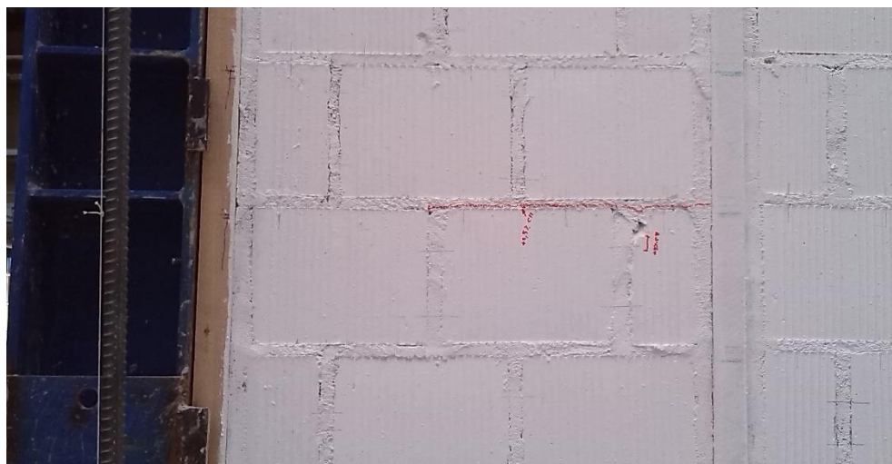
Figura 5.28 - Fessura all'interfaccia malta - mattone, a circa 2/3 dell'altezza del pannello murario (7° filare di mattoni dal basso)
