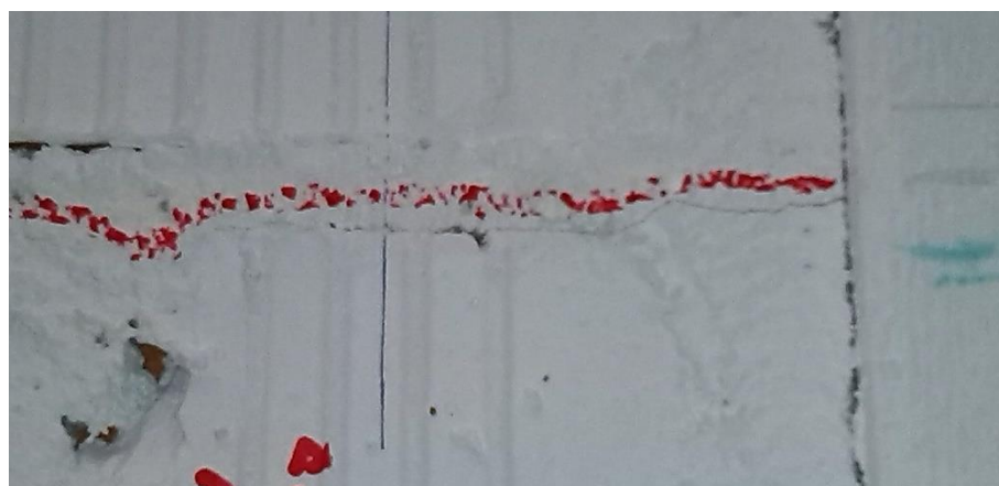
Figura 5.29 - Dettaglio della fessura all'interfaccia malta - mattone, a seguito del ricentraggio. Si noti l'assenza di scorrimenti reciproci, evidenziata dalla continuità della linea verticale tracciata in blu per drift 2,5%
